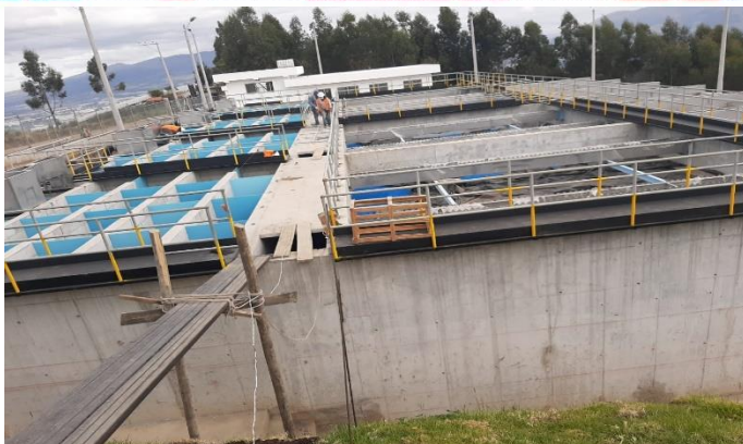
Construcción de la segunda fase del Centro de Gestión del Barrio la Remonta
